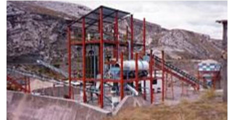
Fig. 4 – Planta de tratamiento
