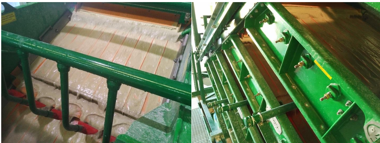
Detalle de la Criba Derrick- Stack Sizer 2SG48-60R-5TK en funcionamiento
